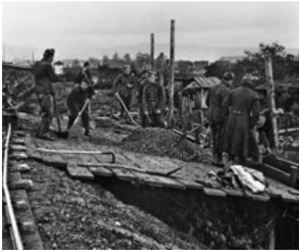
Des prisonniers de guerre français effectuent un coffrage tout près du pont Posselt. 1940 (Lentia-Verlag)
