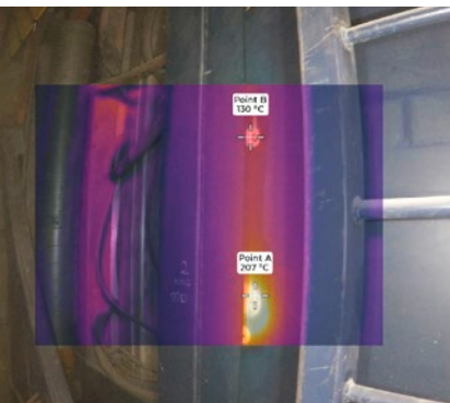
Thermalmessung (Kriechstrom in Schraubenkopf)
