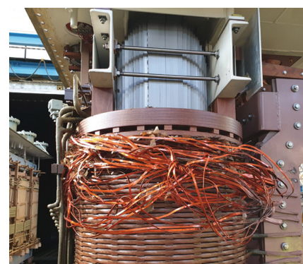
Wicklungsschaden 30kV Trafo
