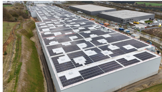
4,9 MWp, foil roof DEE AG/Greenflash GmbH
