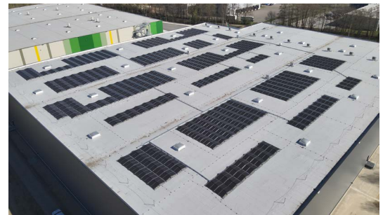
557 kWp, cubierta de lámina SUNKON GmbH
