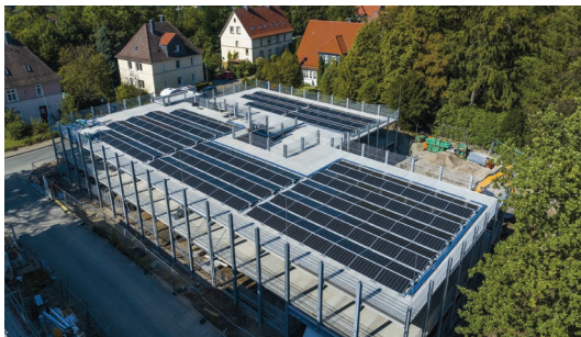
98 kWp, cubierta de hormigón GOLDBECK GmbH
