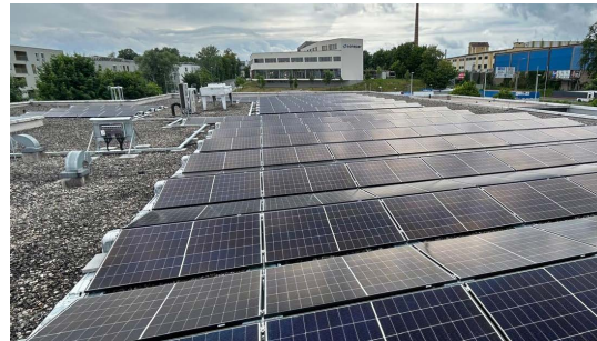
124,67 kWp, cubierta de grava eco-tec.at Photovoltaics GmbH
