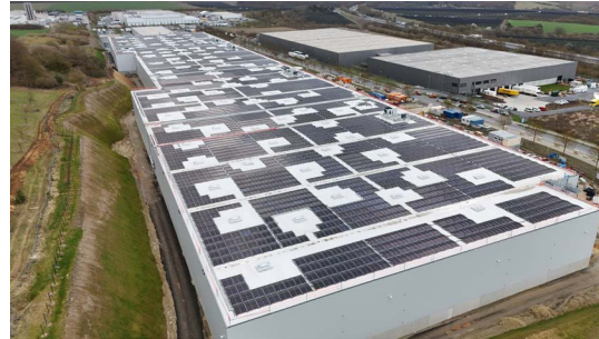
4,9 MWp, cubierta de lámina DEE AG/Greenflash GmbH
