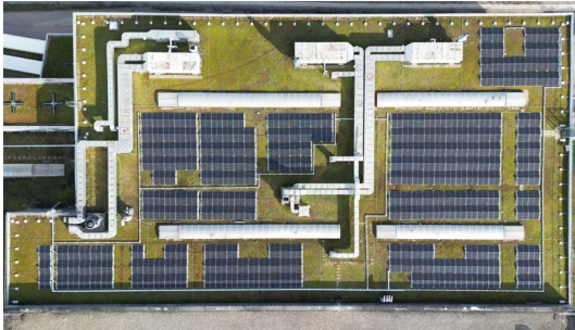
400 kWp, cubierta verde Solarwerk GmbH
