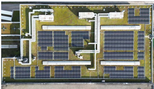
400 kWp, toit végétalisé Solarwerk GmbH
