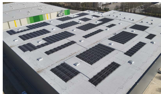
557 kWp, toiture plate SUNKON GmbH
