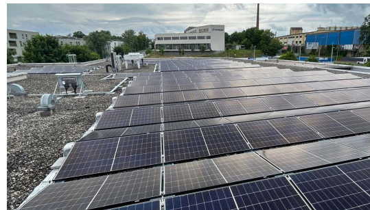
124,67 kWp, toitures gravillonnées eco-tec.at Photovoltaics GmbH
