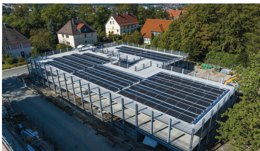
98 kWp, toit en béton GOLDBECK GmbH
