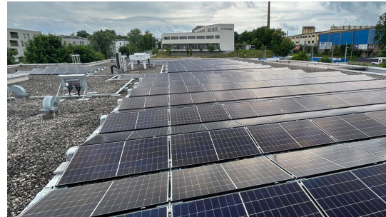
124,67 kWp, Kiesdach eco-tec.at Photovoltaics GmbH
