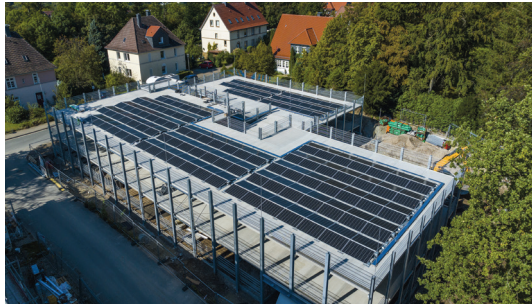
98 kWp, Betondach GOLDBECK GmbH
