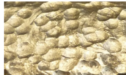
Metal de soldadura martillado
