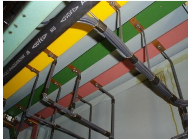
Abb. 40: Keine kurzschluss sichere Verdrahtung von Sammelschienenabgänge
