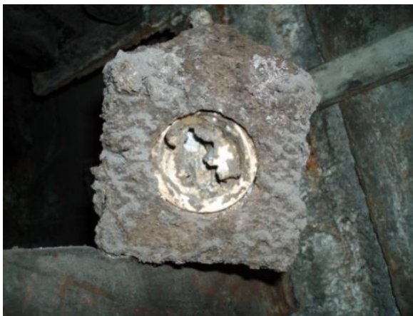
Abb. 32: Verbaute Steckdose für die vorhandene Umgebungsbedingung nicht geeignet.
