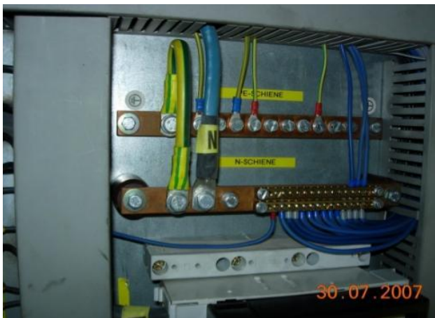
Abb. 13: Erdungsverbindungsleiter nicht vorhanden. 2. Nullungsbedingung nicht erfüllt.
