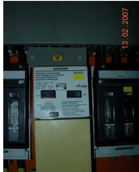
Abb. 31: FI-Zusatzschutzschalter im 500V IT-System eingebaut
