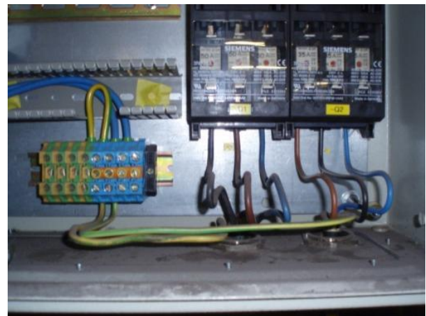
Abb. 14: Erdungsverbindungsleiter nicht vorhanden. Einspeiseseitiger PEN Leiter im Schrank nicht geerdet.
