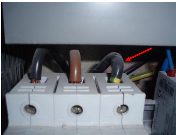
Abb. 25: Eine ge-gr Ader eines Kabels darf NICHT schwarz eingeschrumpft, und als Außenleiter verwendet werden!!
