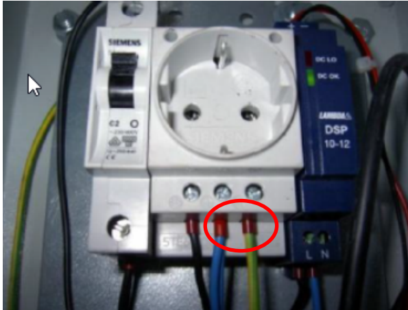
Abb. 1: Schutzleiter - Neutraleiteranschluss vertauscht.
