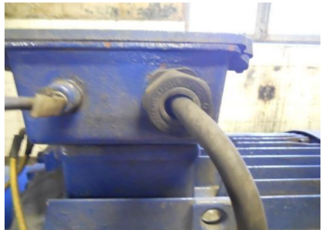
Abb. 50: Kabeleinführung(en) mangelhaft, da undicht.
