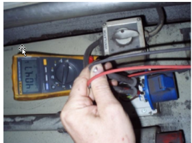
Abb. 4: Außenleiterspannung (400V) an 230V Steckdose.
