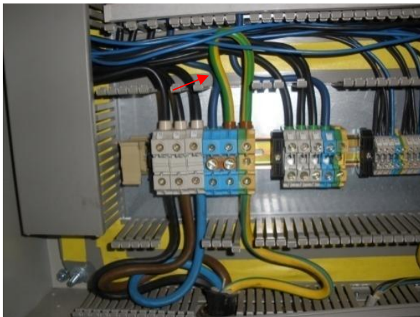
Abb. 11: Das Entfernen des Bügels zu Messzwecke führt zu einer Unterbrechung des Nullleiters! Die Folge können erhebliche Schäden an der elektrischen Anlage bzw. deren elektrischen Betriebsmittel sein.
