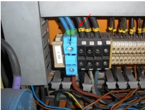
Abb. 17: Doppelt geklemmte Neutraleiter in einer (Einfach)-Klemme. Abgesehen von der mechanisch unzulässigen Klemmung kann dies zu einer Nullleiterunterbrechung, und somit zu großen Schäden in der elektrischen Anlage führen.
